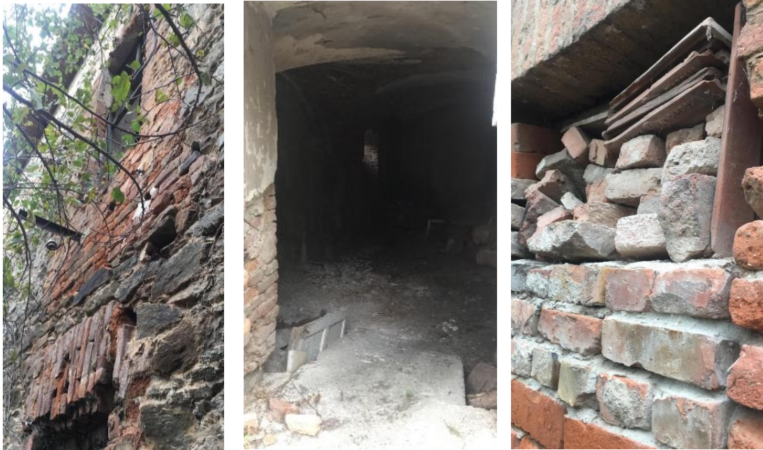
Figura 6 Deteriorări vizibile ale Clădiri administrative a SPMN
